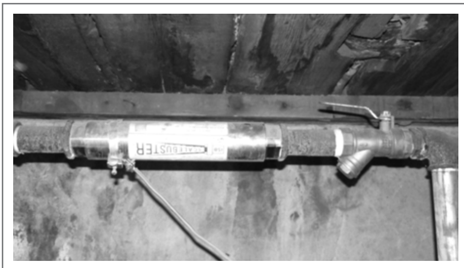
Хатуулаг ихтэй, тунгалаг биш устай Хойд худгийн ус дамжуулах хоолойд суулгасан усны шүүлтүүр
